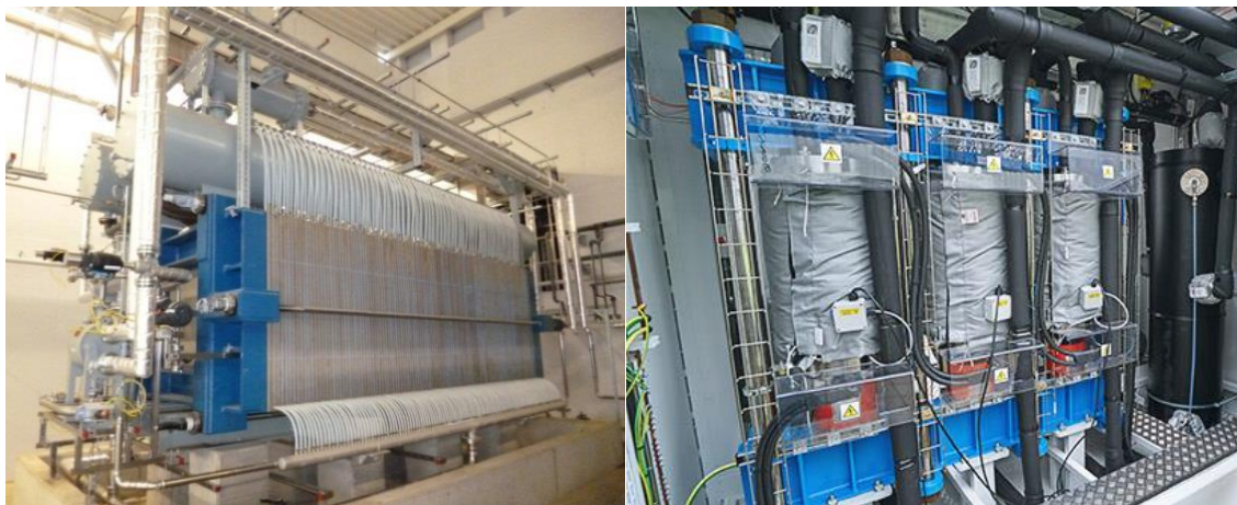
Obr. 8 Alkalická elektrolyza o výkonu 2 MW (vlevo) a PEM elektrolyza o výkonu 150 kW (13) (9)
